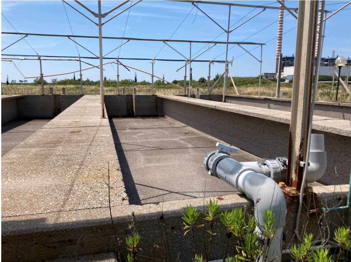
foto 11: vasche di allevamento in manutenzione (rif. 7) - vista da nord (particolare)
