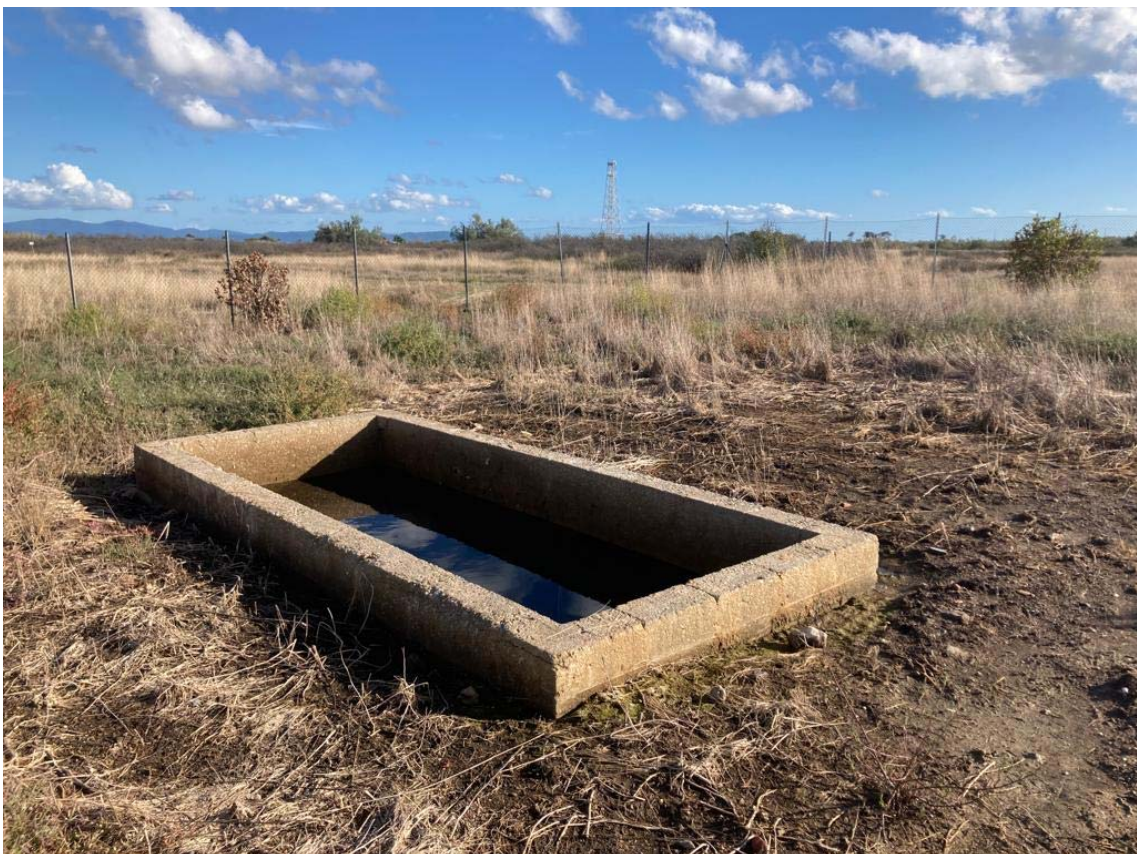
foto 18: costruzioni minori - cassoni unificazione tubazioni (rif. 13) - vista da ovest
