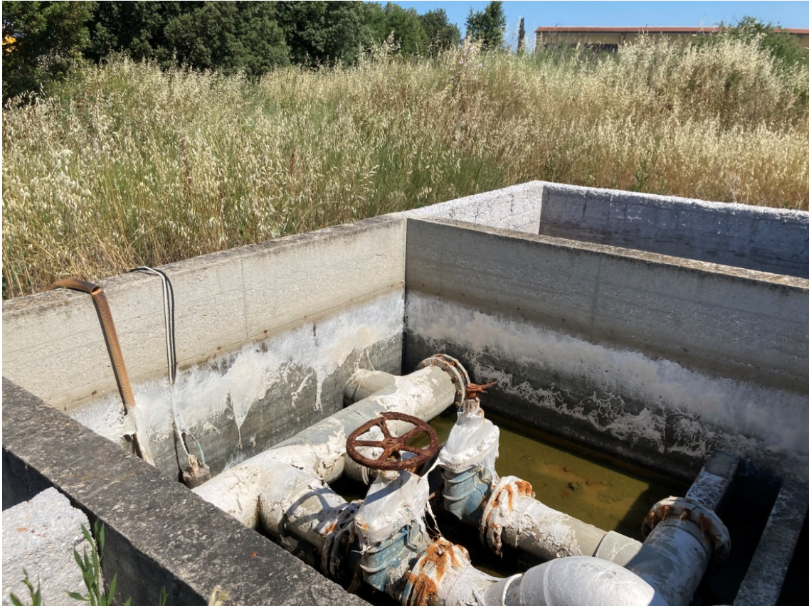
foto 19: costruzioni minori - cassoni unificazione tubazioni (rif. 14) - vista da sud
