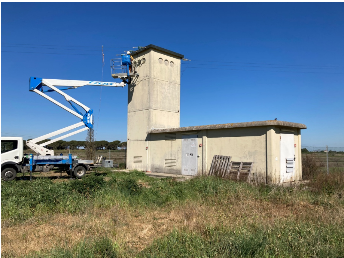
foto 10: cabina di trasformazione ENEL (rif. 6) - vista da sud-est
