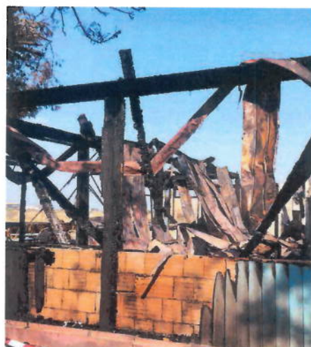
Le fiamme hanno carbonizzato la struttura in legno
