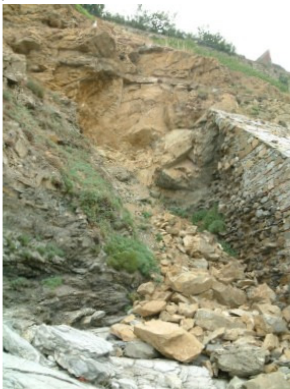
Foto 10: frana attiva tra i barbacani
