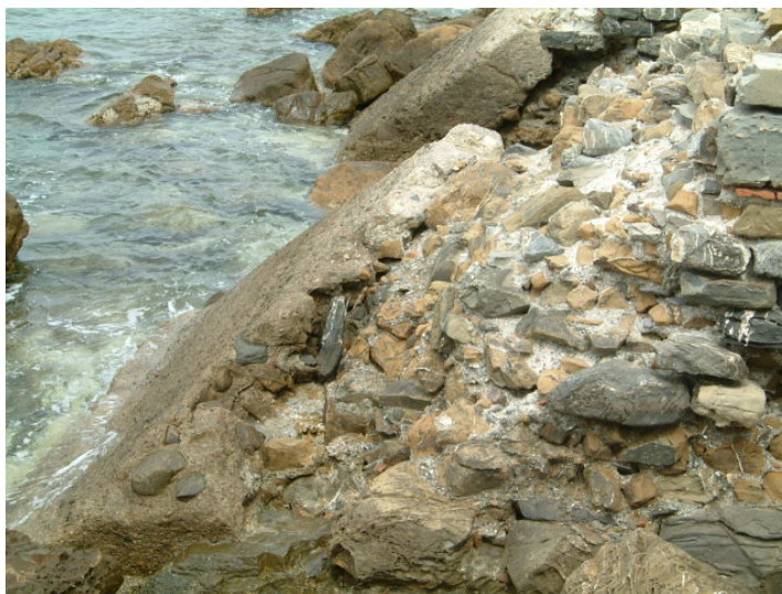
Foto 9: stato di degrado del rivestimento dei barbacani
