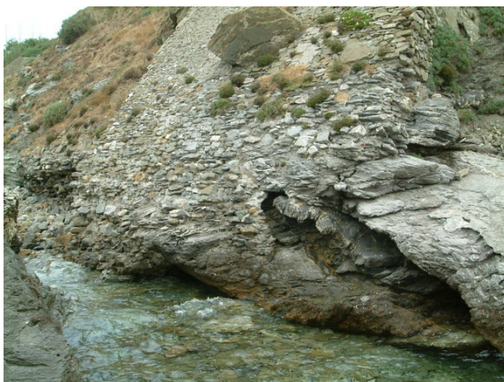
Foto 8: scalzamento al piede in un tratto dei barbacani esistenti
