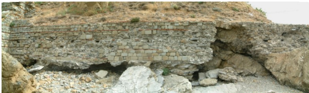
Foto 7: scalzamento al piede del muro della porzione terminale del piazzale di alaggio
