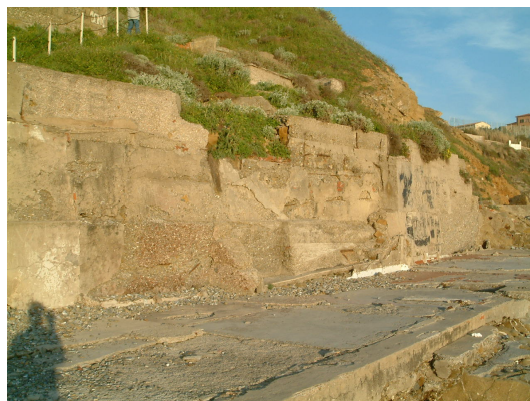
Foto 21 – muro privo di fori per allontanare l'acqua
