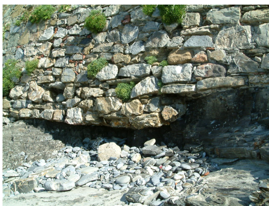
Foto 17 – Scalzamento alla base del muro di Viale del Popolo
