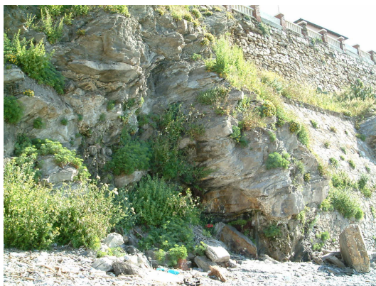
Foto 16 – Parete in roccia con crolli in prossimità del muro di Viale del Popolo
