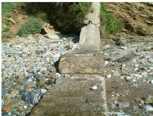
Foto 14 – Lo scarico in cemento favorisce l'accumulo della spiaggia in sinistra mentre a destra prevale l'erosione
