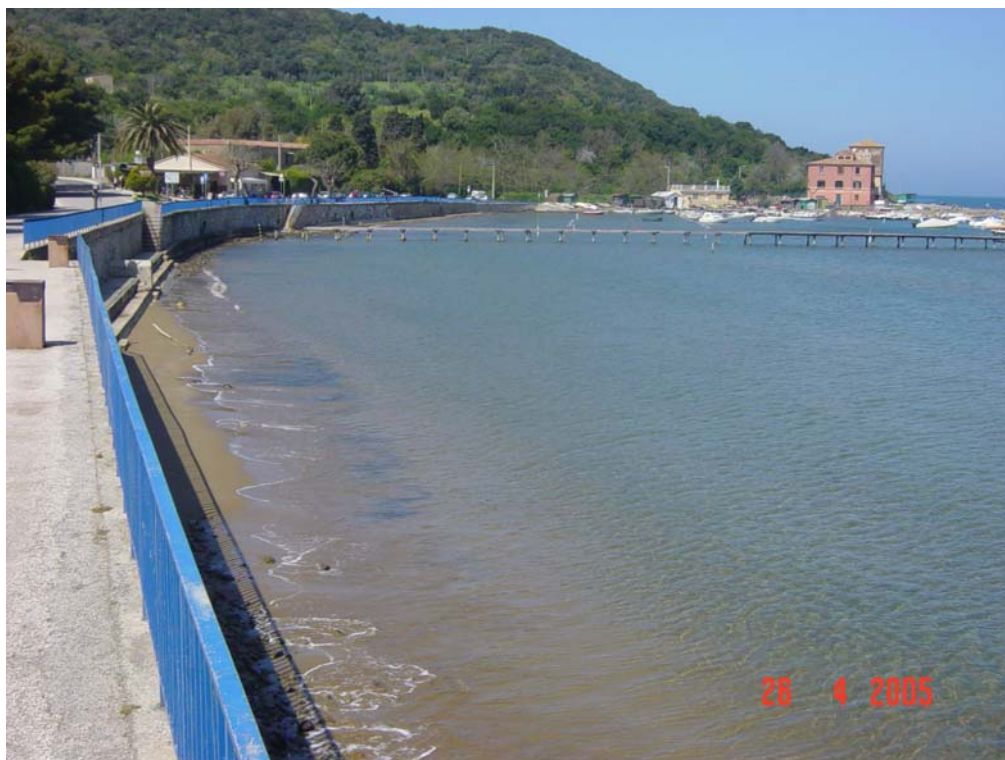
Figura 6 – Muro a retta e strada litoranea all'estremità sud (26 aprile 2005)
